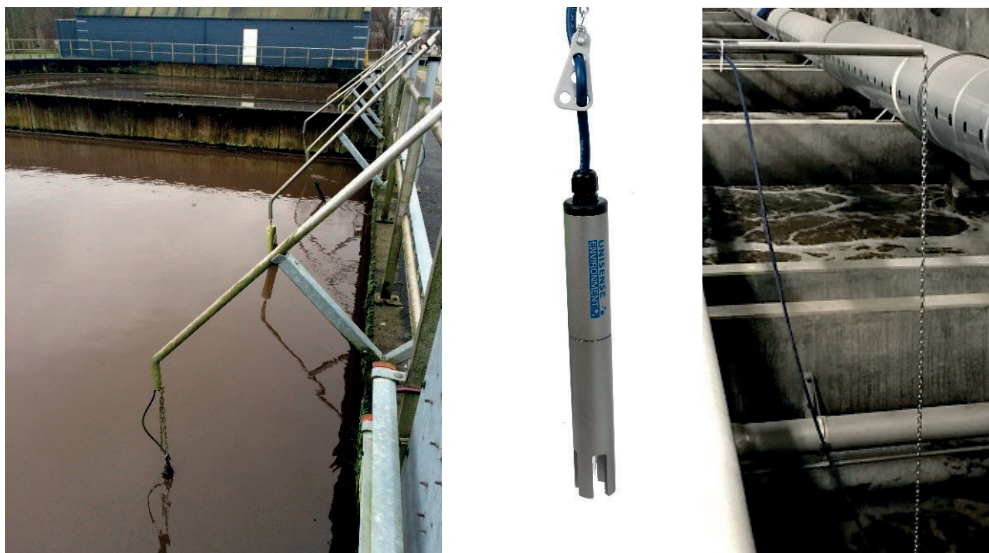
Løsning på ophæng af N 2 O Wastewater Sensoren i spildevand
