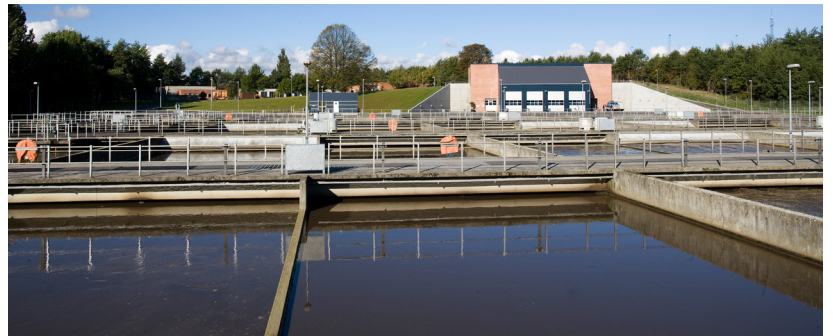
Kläranlage Ejby Mølle, Foto: VCS Denmark
